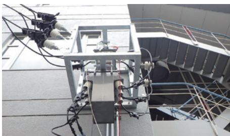
高圧気中開閉器
