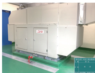
非常用発電設備竣工
