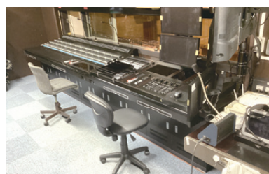
調光操作卓 竣工
