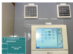
集中アドレス設定 運転確認
