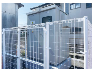
キュービクル 外観
