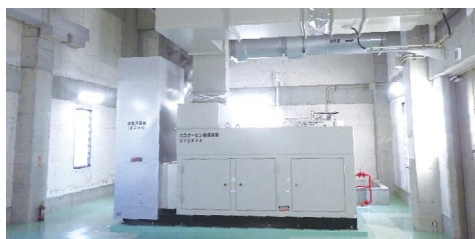
ガスタービン発電装置 375KVA 完成
