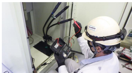
高圧ケーブル絶縁抵抗測定
