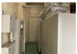
室内機据付完了
