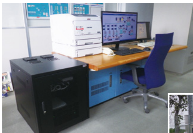
中央監視装置
