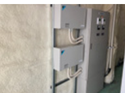
空調制御盤据付状況
